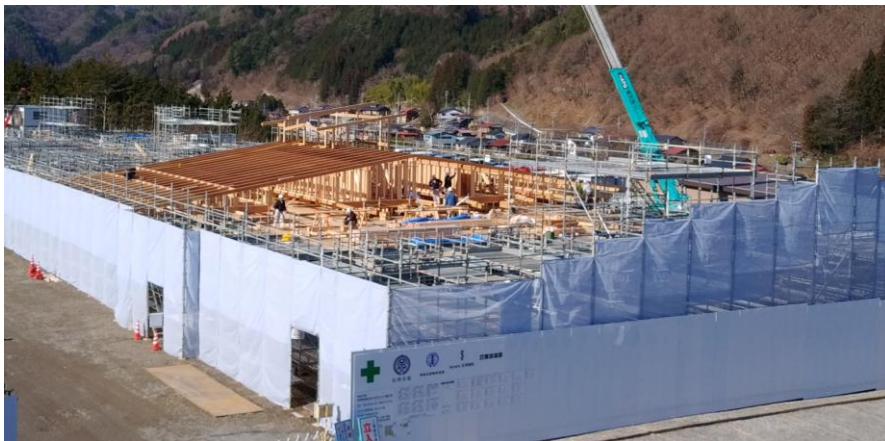
順調に工事が進む役場本庁舎・防災センター(3月12日撮影)
